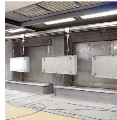
京都工場 クリーンルーム内
