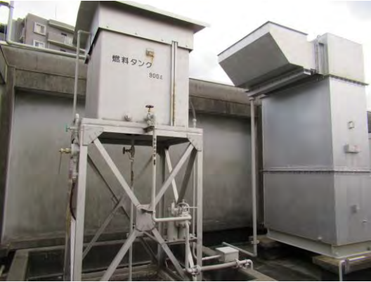
④屋外設備機器の架台
