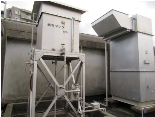
④屋外設備機器の架台
