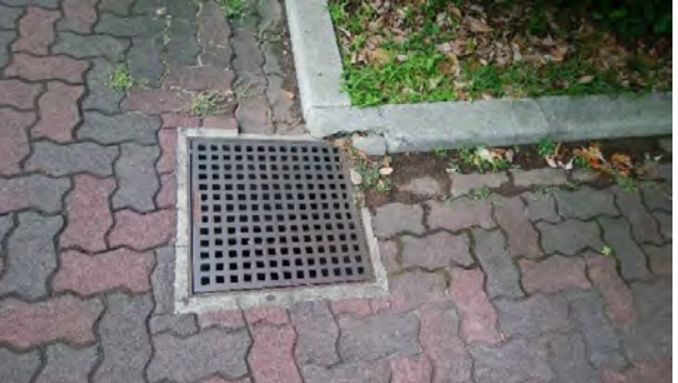
■割れている縁石
