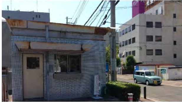
■外部鉄部 錆部分
