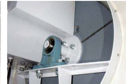
産業用除湿機(施工後)
