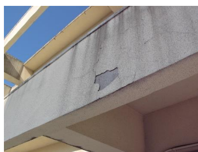
庁舎別館 外壁：D 仕上げ材の剥がれ
