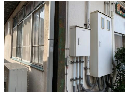
上野口保育園 外部雑：D 柱の錆
