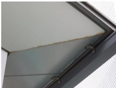
放課後児童クラブ（東小） 屋根・屋上：C 軒天の錆／歪み
