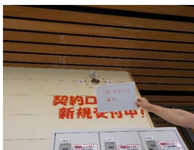
市立総合体育館 建物内部：C 天井の漏水痕
