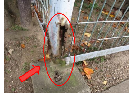
ネオコーポ門真東Ⅱ集会所 外部フェンス 柱の腐食
