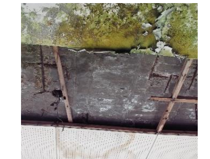
旧北小学校(倉庫(旧校舎)) 建物内部：D 漏水
