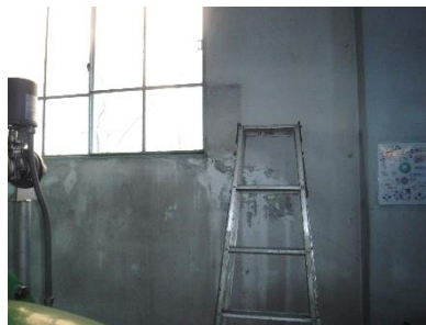
桑才排水機場 建物内部：C ひび
