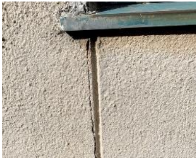
上野口保育園 外壁：D ひび
