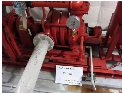
保健センター 防災消防設備：D 消防ポンプの漏水
