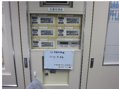
保健センター 空調換気排煙設備（全体）：D ファンコイル集中コントローラー不良
