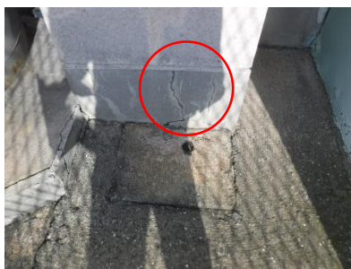
下八箇荘排水機場 外壁：D ひび
