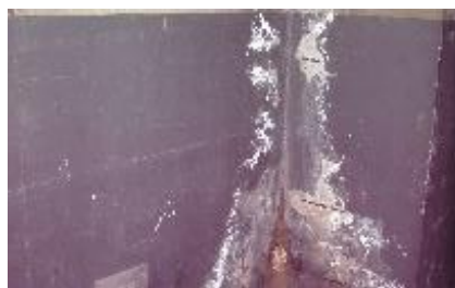
門真プラザ地下駐車場 外壁：D 白華と錆汁
