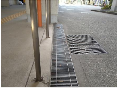
門真市民プラザ体育館 外部雑：D 手すりのぐらつき
