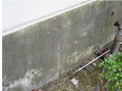
南門真ハイライフ自治会館 外壁：C コケ
