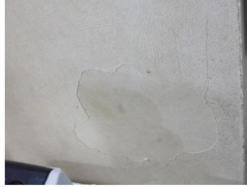
放課後児童クラブ（門真みらい小） 建物内部：C 壁紙の剥がれ
