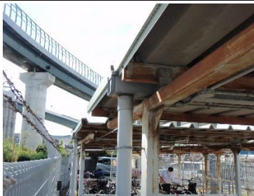
門真南駅自転車駐車場（北） 外壁：D 柱の錆
