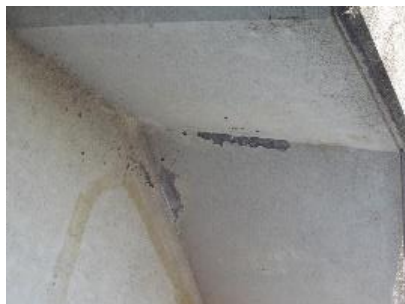
庁舎本館（旧技術棟） 外部雑：C 爆裂／錆
