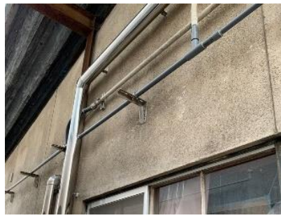
上野口保育園 外壁：D 錆／チョーキング（塗装の劣化）
