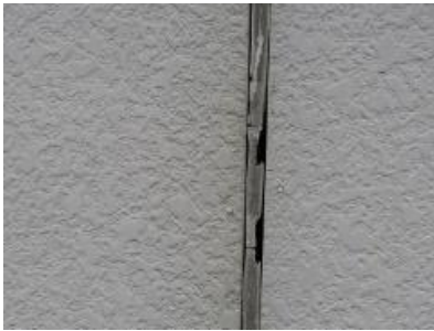
末広自治会館 外壁：C 目地劣化
