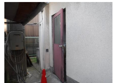
桑才排水機場 窓・扉（外部）：E 扉開閉不良
