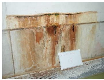
門真南駅自転車駐車場（第1） 建物内部：C 漏水
