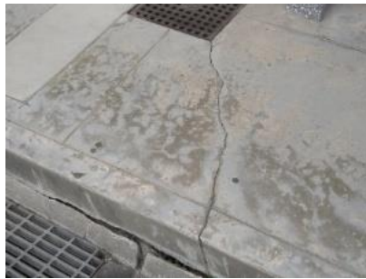
門真市民プラザ体育館 外部雑：D 土間のひび
