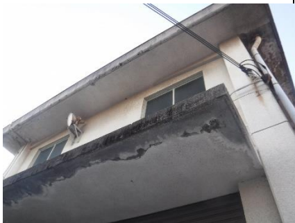
桑才排水機場 外部雑：E 仕上げ材の剥離
