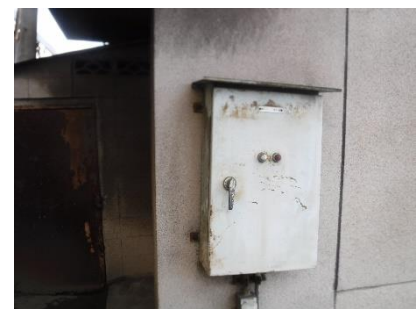
下八箇荘排水機場 電気設備(個別)：A ボックスの錆
