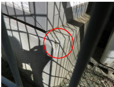
ネオコーポ門真東自治会館 外壁：D 深いひび
