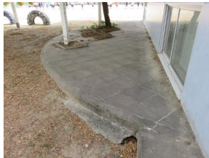
放課後児童クラブ（東小） 外部雑：C 土間の沈下／欠損
