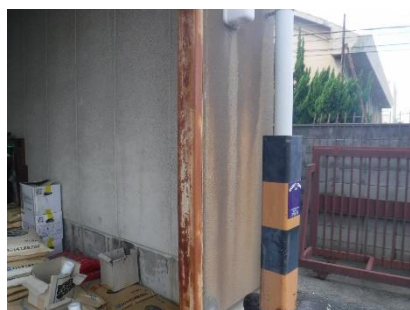
道路作業所 外部雑：E 錆
