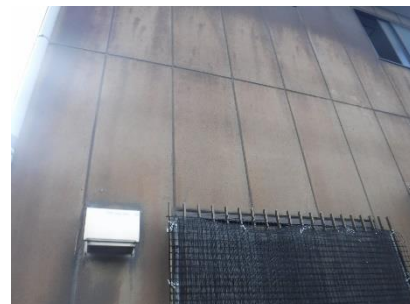
道路作業所倉庫 外壁：D 汚れ
