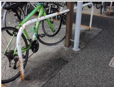
門真南駅自転車駐車場（東） 外部雑：D 手すりの錆
