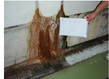
門真南駅自転車駐車場（第1） 建物内部：C 漏水
