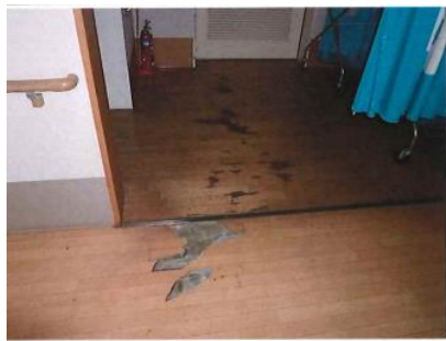
保健センター 建物内部：C 床材の剥がれ
