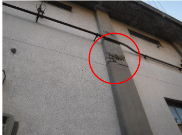
桑才排水機場 外壁：E 内部鉄筋の露出
