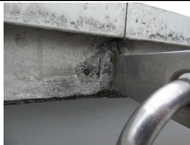
ルミールホール 屋根・屋上：C 丸環部分ひび
