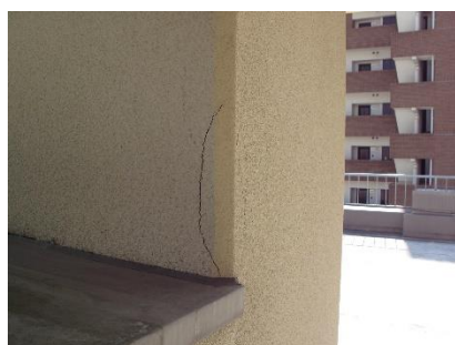
庁舎別館 外壁：D 仕上げ材の割れ
