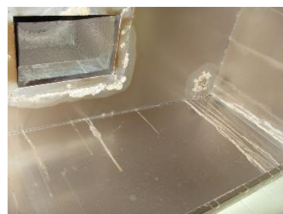
庁舎別館 建物内部：D 雨漏り痕
