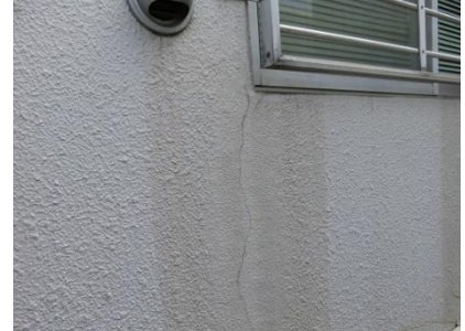
南門真ハイライフ自治会館 外壁：C ひび
