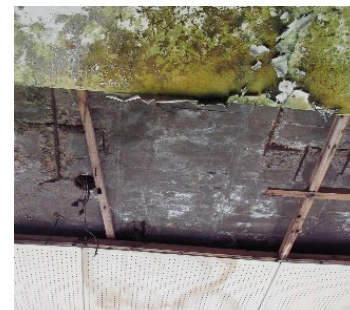
旧北小学校(倉庫(旧校舎)) 建物内部：D 漏水
