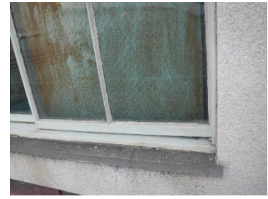
桑才排水機場 窓・扉（外部）：E パッキン劣化
