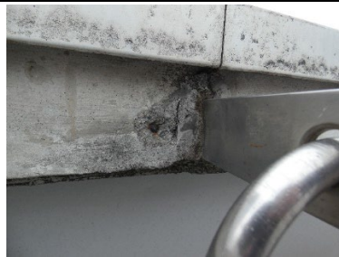
ルミールホール 屋根・屋上：C 丸環部分ひび
