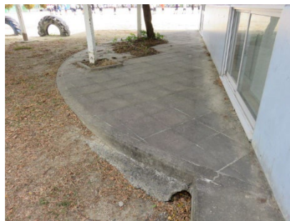
放課後児童クラブ（東小） 外部雑：C 土間の沈下／欠損
