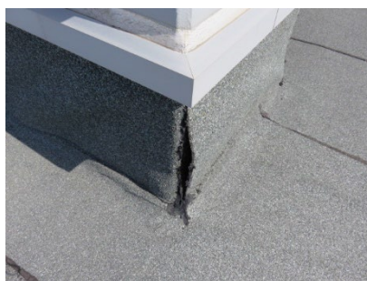
南部市民センター 屋根・屋上：E 防水層の捲れ
