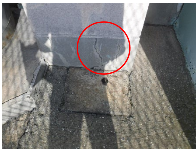
下八箇荘排水機場 外壁：D ひび
