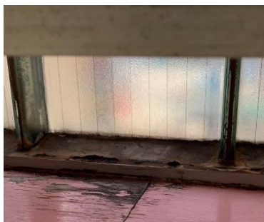
大和田幼稚園 窓・扉（外部）：D 玄関扉の錆／パッキンの劣化
