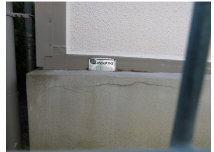
ネオコーポ門真東自治会館 外壁：D ひび
