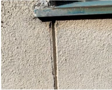
上野口保育園 外壁：D ひび
