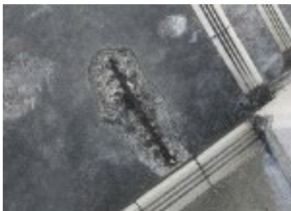
南門真ハイライフ自治会館 外部雑：C 爆裂と露筋
