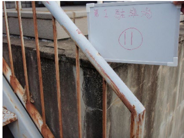
門真南駅自転車駐車場（第1） 外部雑：A 手すりの錆
