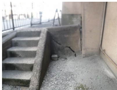
下八箇荘排水機場 外部雑：D 土台の欠損／ひび
