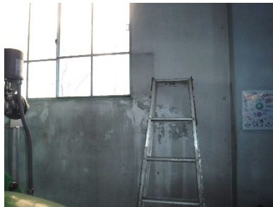
桑才排水機場 建物内部：C ひび
