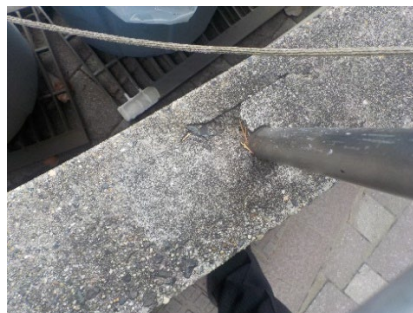
門真市立テニスコート・ 青少年運動広場／管理棟 外部雑：C 手すり根本ひび
