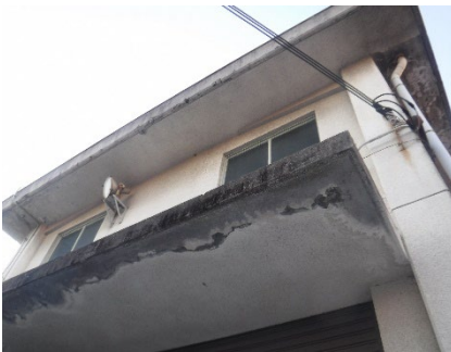
桑才排水機場 外部雑：E 仕上げ材の剥離
