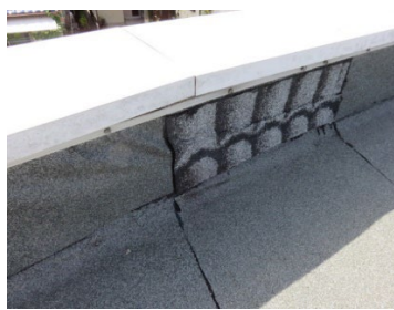
南部市民センター 屋根・屋上：E 防水層の浮き
