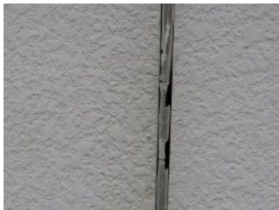
末広自治会館 外壁：C 目地劣化
