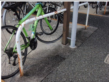
門真南駅自転車駐車場（東） 外部雑：D 手すりの錆
