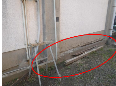
桑才排水機場 外壁：E 外壁基礎の欠損
