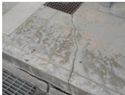
門真市民プラザ体育館 外部雑：D 土間のひび
