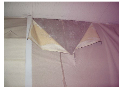
ブックセンター跡（門真プラザ内） 建物内部：C 内装の剥がれ
