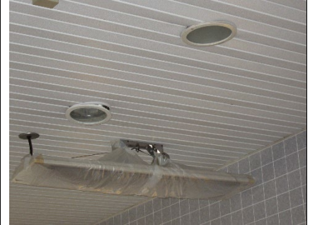
保健センター 電気設備（個別）：B
