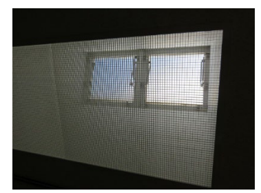
南部市民センター 窓・扉（外部）：D 排煙窓の開閉不良
