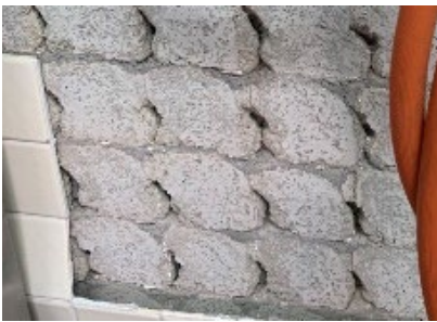
上野口保育園 建物内部：D 壁タイル剥離
