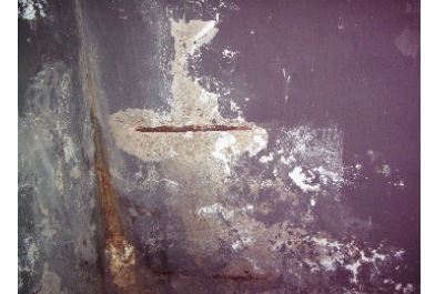
門真プラザ地下駐車場 外壁：D 白華と錆汁
