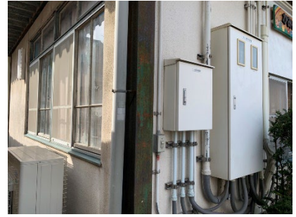
上野口保育園 外部雑：D 柱の錆
