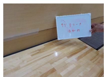
市立総合体育館 建物内部：C 床材の剥がれ
