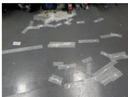
市立総合体育館 建物内部：C 床材の剥がれ
