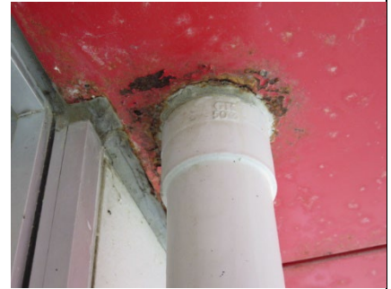
放課後児童クラブ（東小） 外部雑：C 玄関天井裏の白華・錆・腐食
