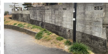
ブロック塀（地震時 に倒壊の危険あり）
