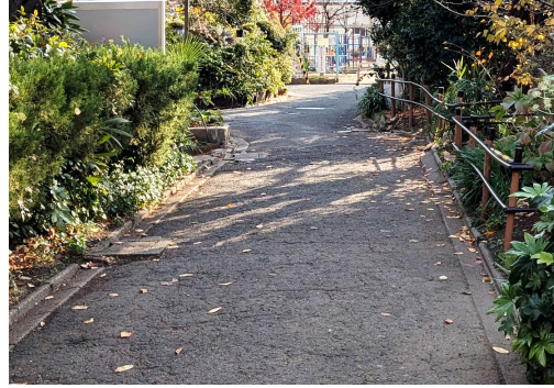
通路の舗装が劣化している
