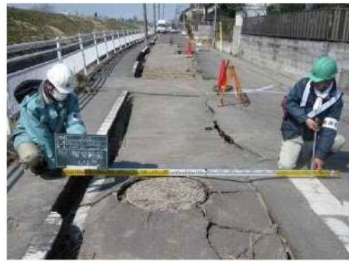
マンホール周辺の地盤沈下
