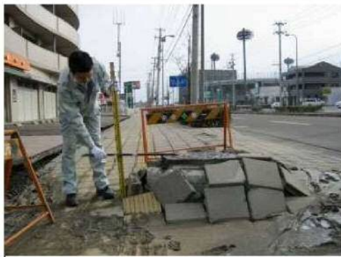
液状化によるマンホール浮上
