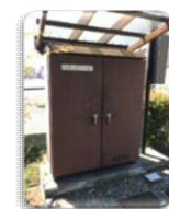
給水モニター外観
