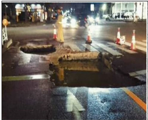
<下水道管の老朽化による道路陥没の例>
