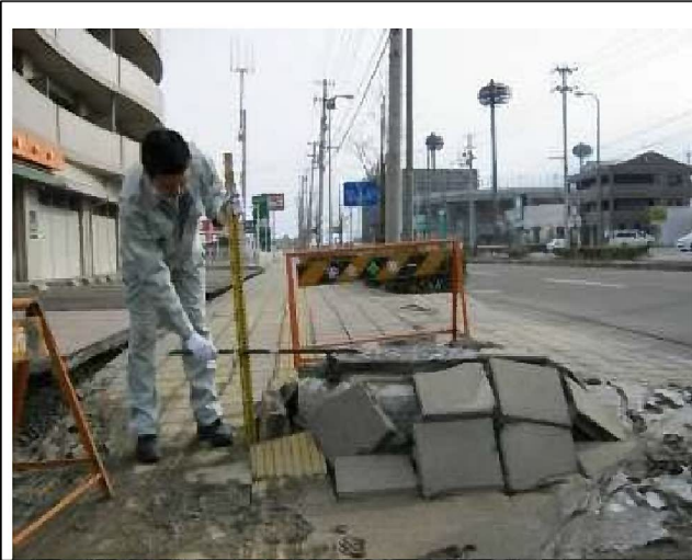
<地震による被害の例（マンホールの浮き上がり）>
