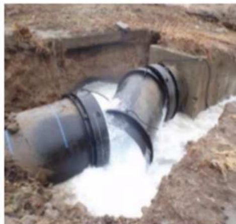
被害を受けた水道管
