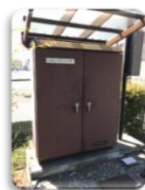
給水モニター外観
