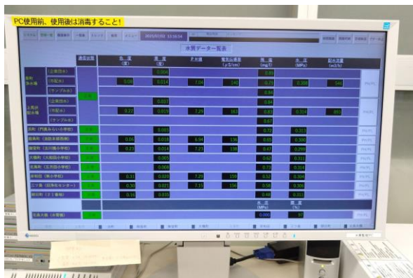
給水モニタ中央装置 24 時間市内 10 箇所の水質を監視
