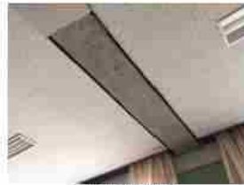
モルタルが落下した梁
