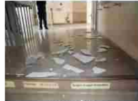
落下したモルタル
