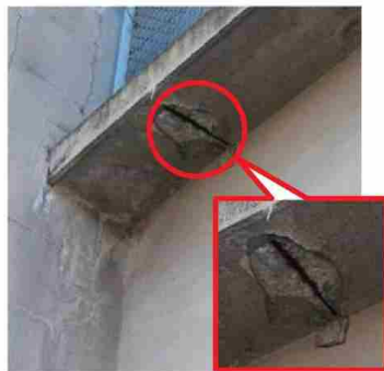
写真2. 軒裏のモルタルの剥落
