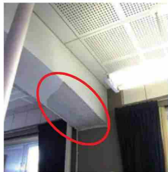
写真1. 教室梁下のモルタルの剥落
