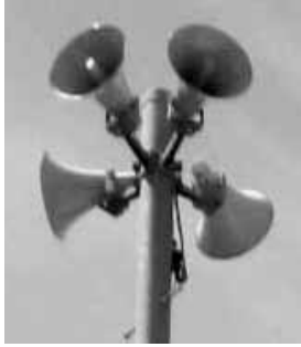
市内に設置された屋外スピーカー
