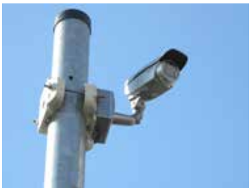
公園に設置予定の防犯カメラ
