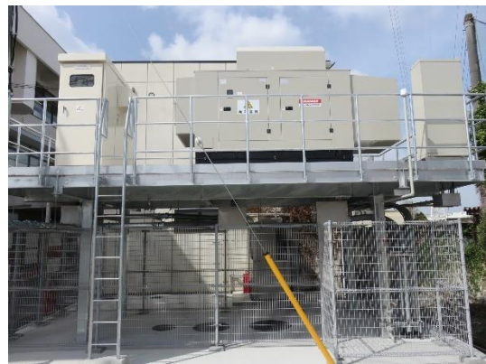
非常用電源設備（別館北東）
