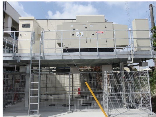
非常用電源設備（別館北東）
