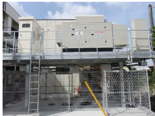
非常用電源設備（別館北東）
