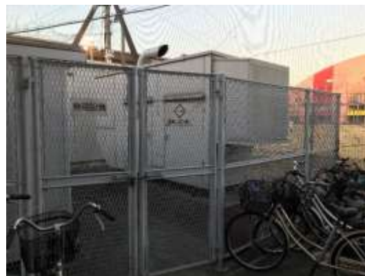
非常用電源設備（別館北東）
