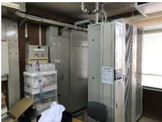
危機管理課内の防災関連設備スペース
