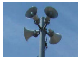
防災行政無線屋外スピーカー
