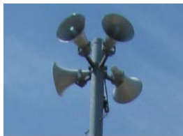
防災行政無線屋外スピーカー
